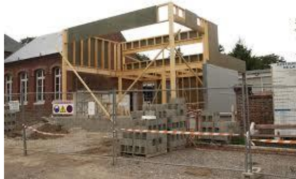
Figure 1: Système de chauffage en géothermie sur la commune de Brailly-Cornehotte
